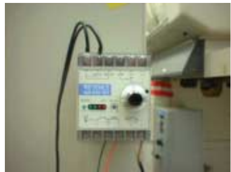
図11 振動加速度アンプユニット
