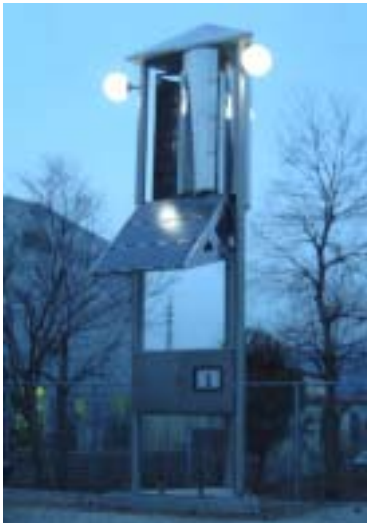
写真 6 . 風力・太陽光ハイブリット発電街路灯 (高知県南国市道の駅)
