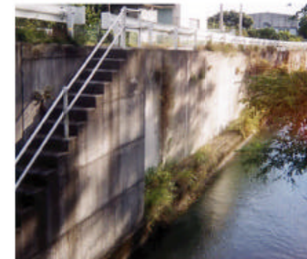
④道路と川との高低差 川と道路との段差が大きく川に触れる事ができない。
