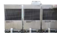
A棟屋上に並ぶ室外機
