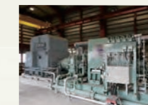
蒸気タービン(右)と発電機(左)
