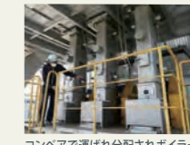
コンベアで運ばれ分配されボイラーに
