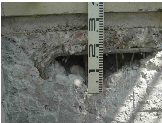
写真1 柱梁接合部のジャンカの例
