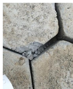
図-18 ブロックの隙間への車両荷重による欠け
