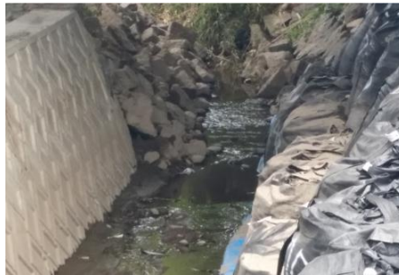
写真 3：熊本地震による護岸被害
