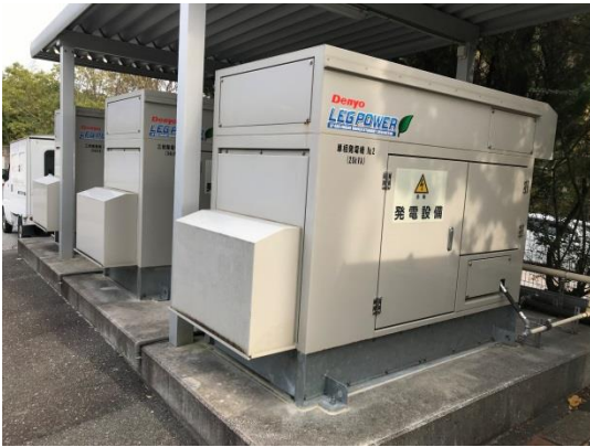
図 6-1 LP ガス発電機（著者撮影）
