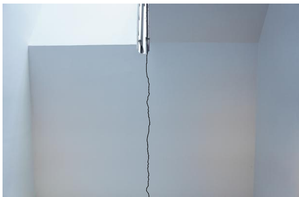
(b) 写真(a)の床の裏面ひび割れ 写真 1 3 階北側のひび割れ
