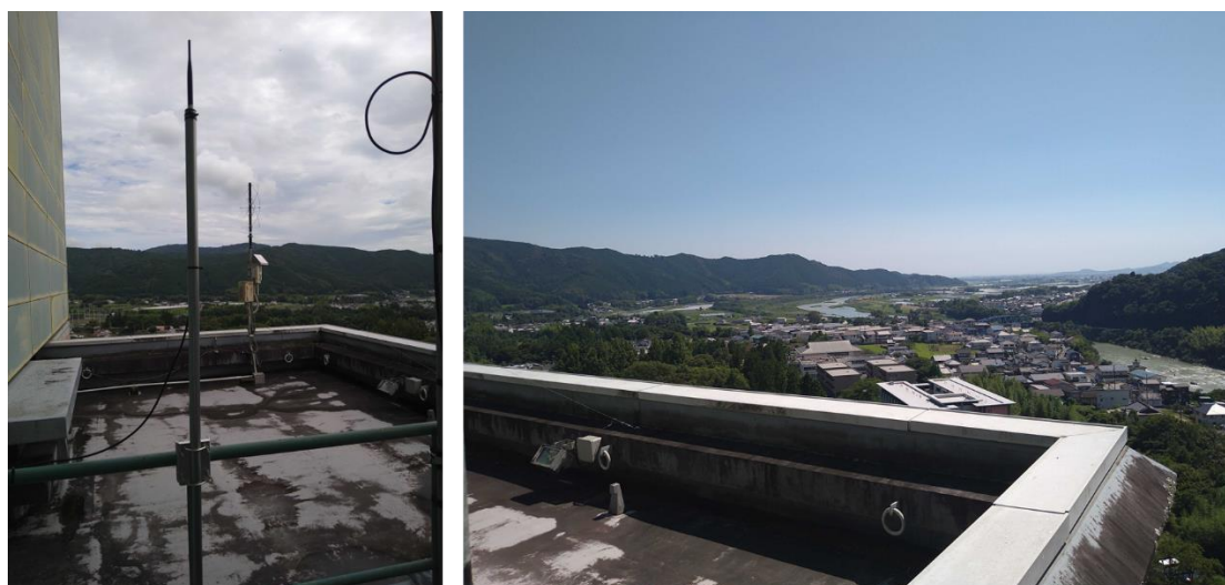
図 2.2 LPWA のアンテナ設置状況と設置地点(南南西方向を望む)
